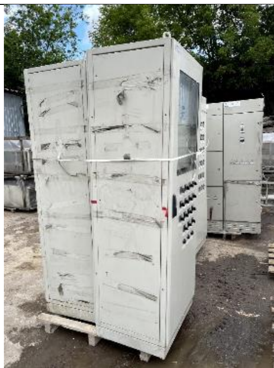
Фото 48 Шкаф №40 суммарный МТЗ трансформатора Т5
