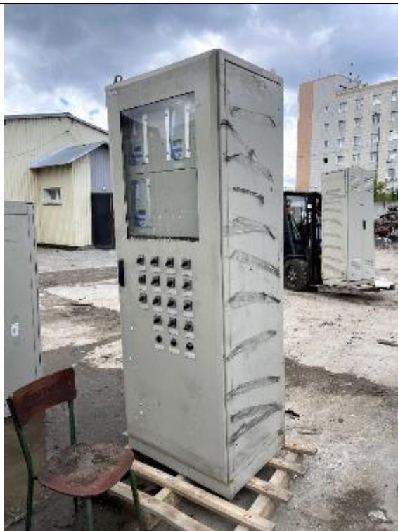
Фото 45 Шкаф №14 суммарный МТЗ трансформатора Т3
