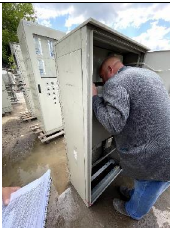
Фото 35 Шкаф силовой навесной 380В (ГР503- 1227-2-2УХЛ-В)
