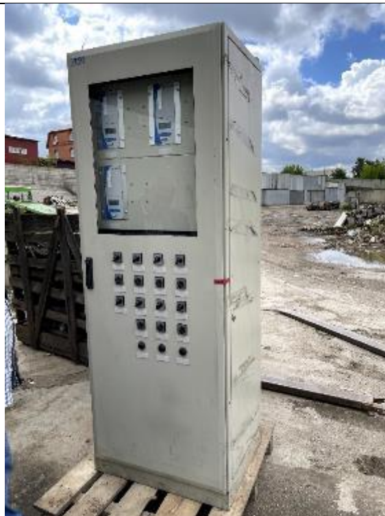
Фото 50 Шкаф №41 суммарный МТЗ трансформатора Т6 (2)
