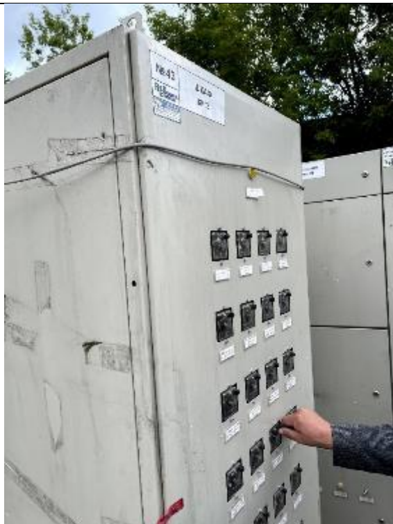
Фото 15 Панель №43 торц. прав. в комплекте с шкафом №43 КИГЗ (1)
