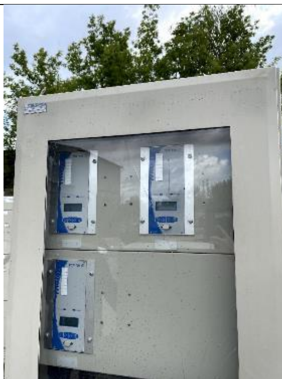
Фото 52 Шкаф №8 суммарной МТЗ трансформатора Т1 (1)
