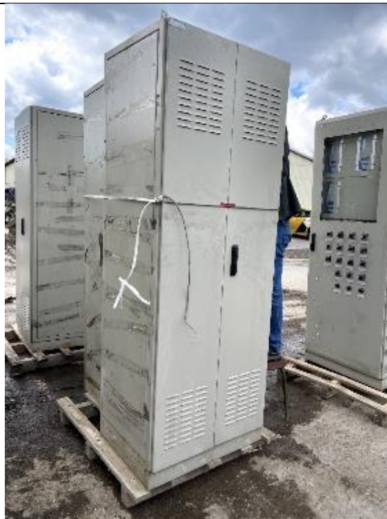
Фото 40 Шкаф №11 суммарный МТЗ трансформатора Т2 (1)
