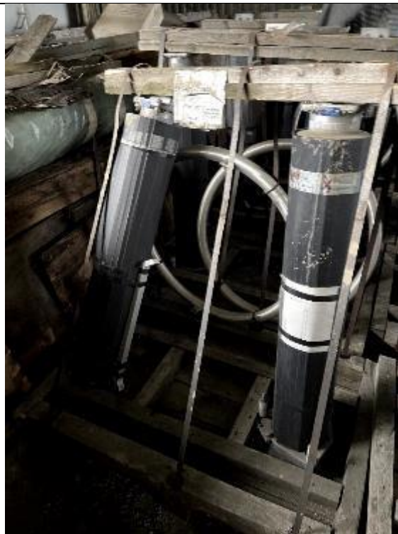
Фото 10 Ограничитель перенапряжения 220кВ 3EL2 192-2PJ32-3N
