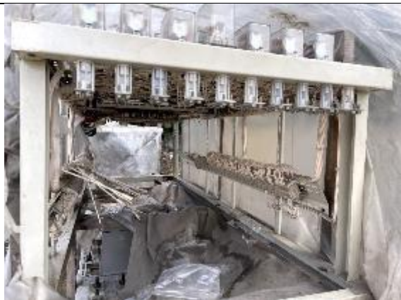
Фото 17 Панель №48 устройства АЧР Т5, Т6 (1)
