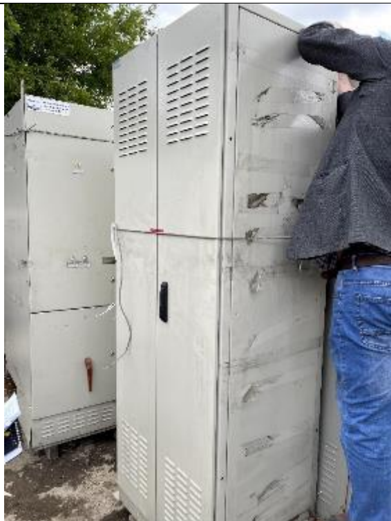
Фото 41 Шкаф №11 суммарный МТЗ трансформатора Т2 (2)
