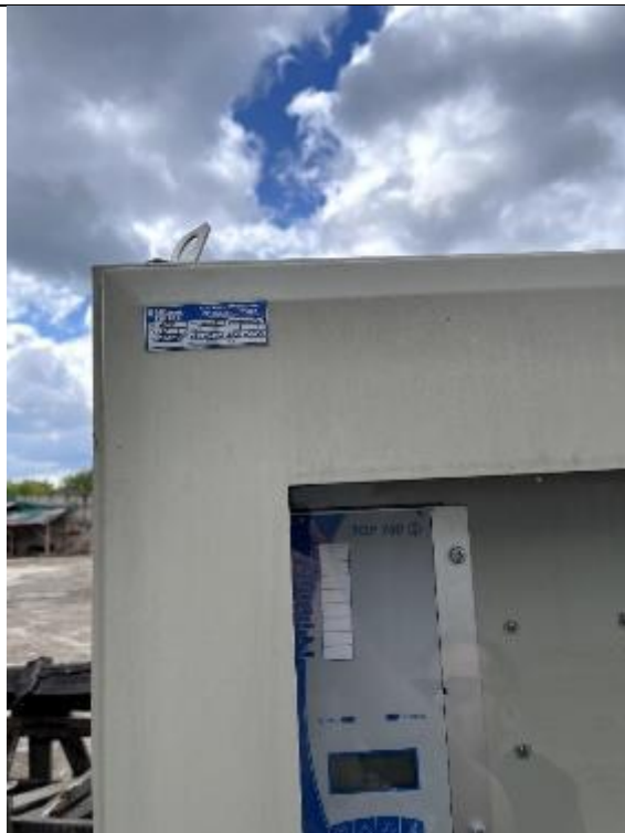
Фото 49 Шкаф №41 суммарный МТЗ трансформатора Т6 (1)
