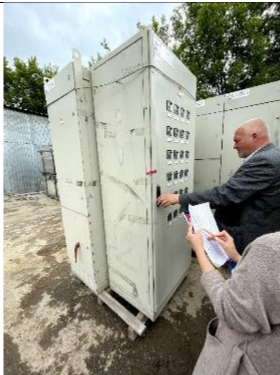
Фото 16 Панель №43 торц. прав. в комплекте с шкафом №43 КИГЗ (2)
