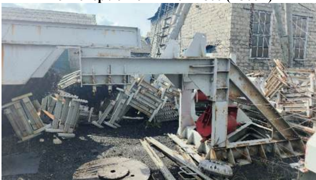
Конвейер ленточный ЛК-800 (L300м)
