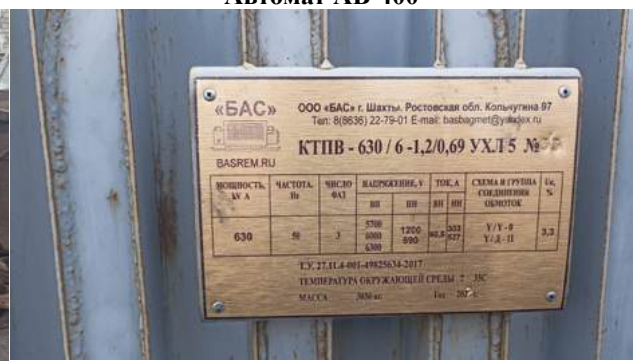
Трансформаторная подстанция КТПВ-630/6-1,2/0,69
