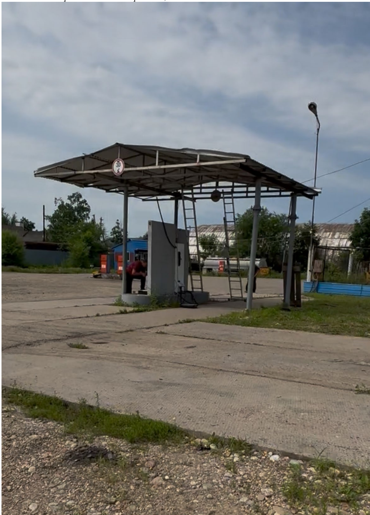
10. Газозаправочные колонки рабочие, 2 шт.
