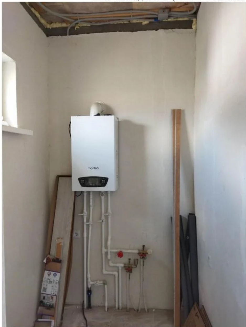
Фото 30. Подсобное, электрический котел (пом. №2 с
